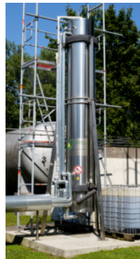
Abbildung 14: Pilotreaktor auf der Kläranlage Garching.
